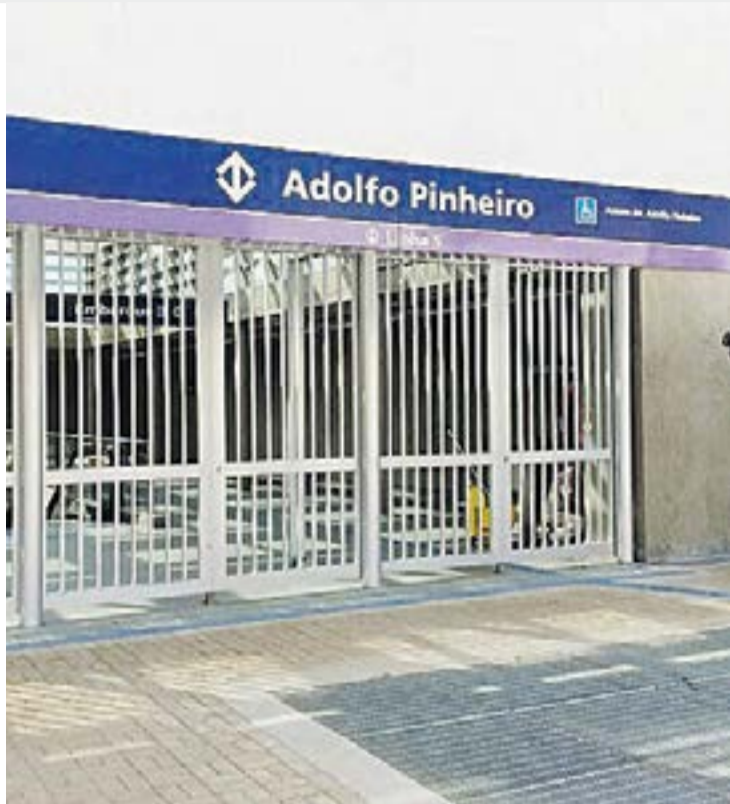
Estação Adolfo Pinheiro é questionada pelo TCE sobre obras inacabadas
